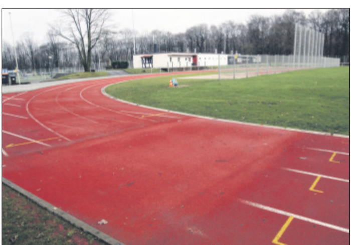
Gleich an mehreren Stellen sieht die Laufbahn der Bezirkssportanlage Freudenberg so aus – nach erst anderthalb Jahren...
